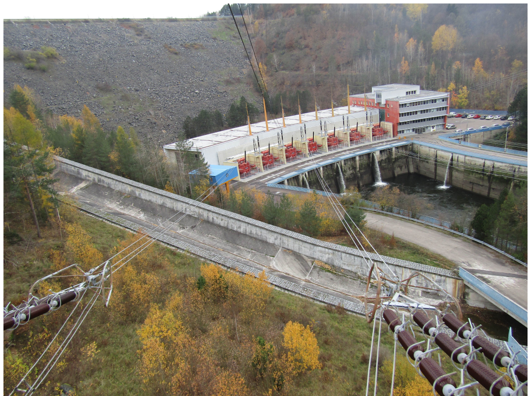
Obrázek 3.7: Blokové transformátory v PVE Dalešice. zdroj: interní archiv ČEPS
